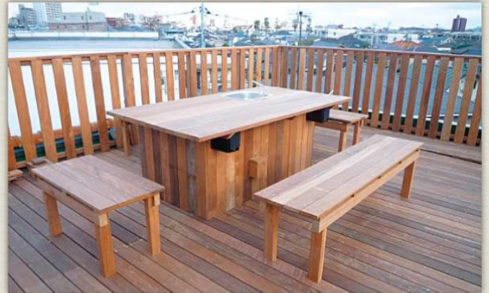
戸建屋上にデッキフェンス、テーブル、イス、シンクを施工
